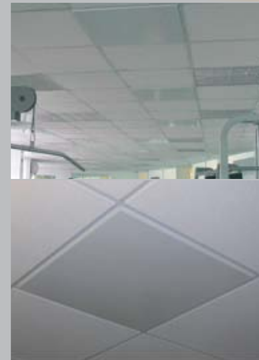
Kattopaneeliin upotettuja lämmityspaneeleita - PRS
